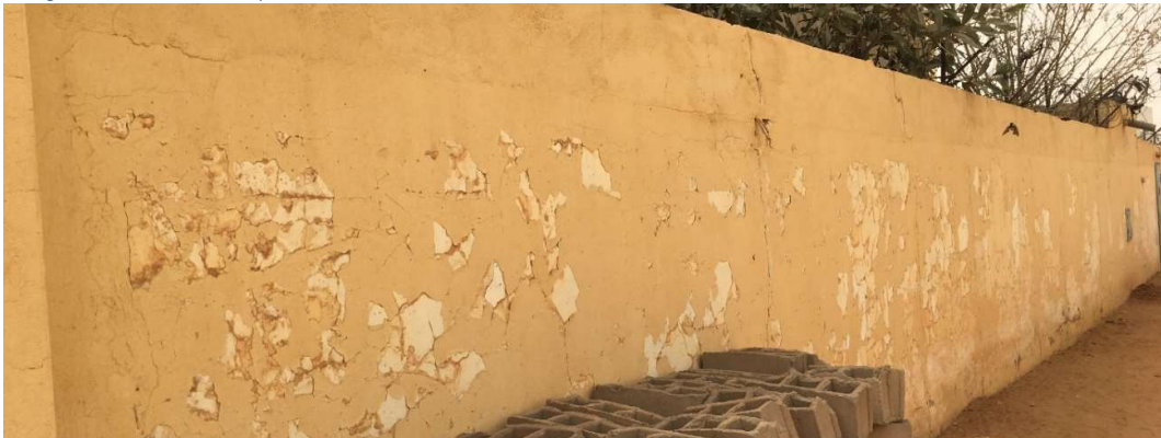
Image 3. Etat actuel de la peinture extérieure du mur de clôture de la GH
